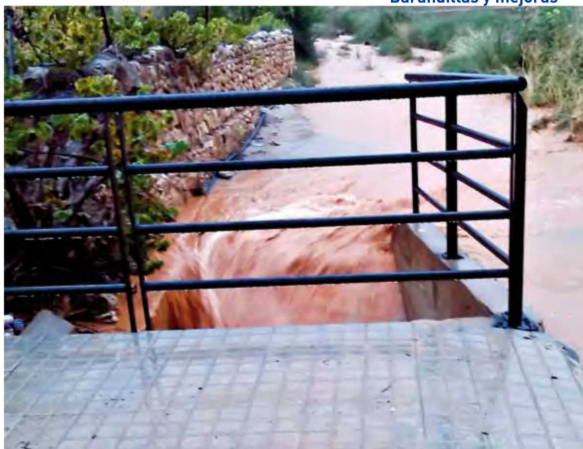
Barandillas y mejoras
